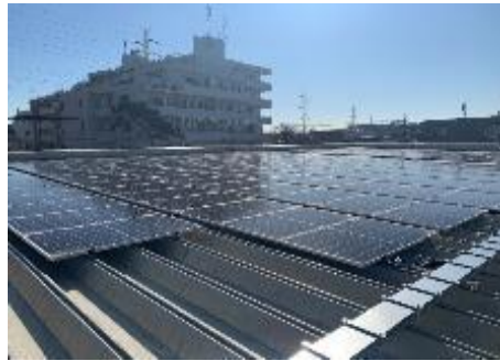
太陽光パネル
